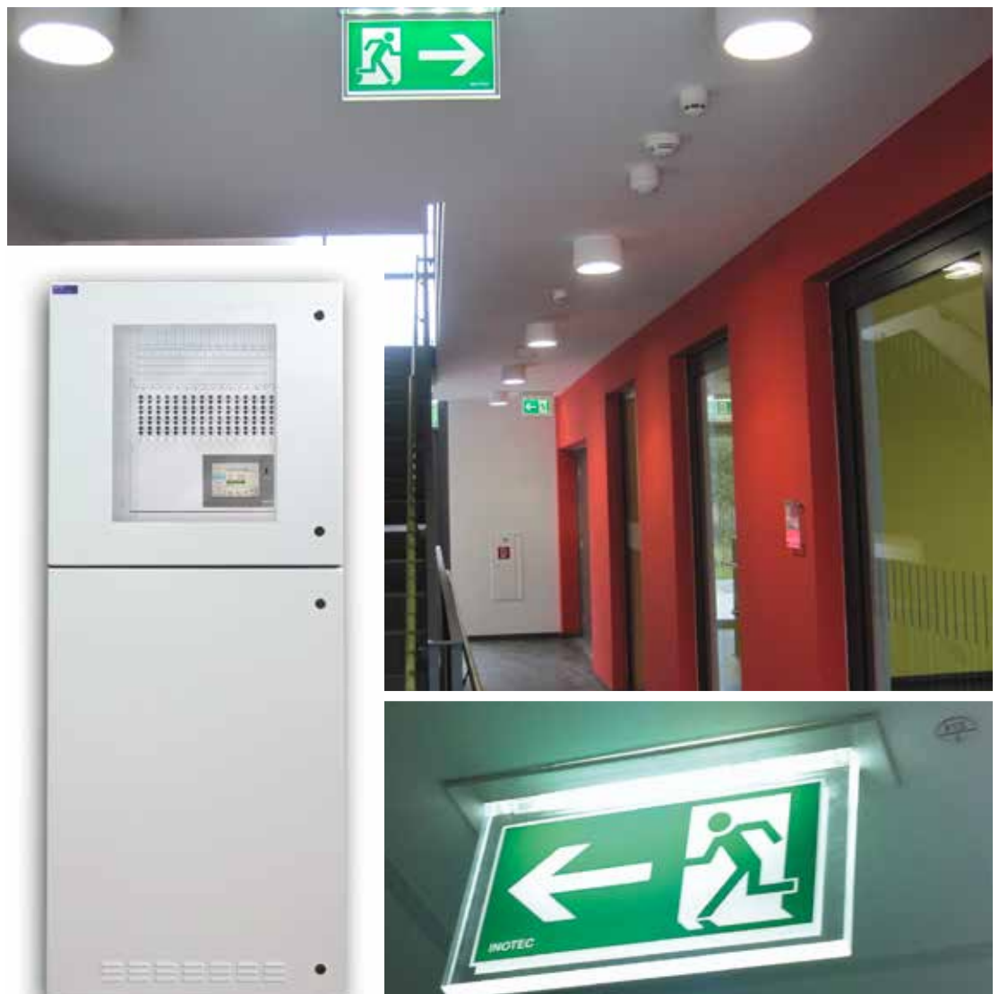
Bild 2: Notbeleuchtungs-Systeme (im Hintergrund der Blick in einen Flur des Landesgymnasiums für Musik Dresden, die Technik stammt von der Klett Ingenieur GmbH) arbeiten mit leistungsstarken Zentralbatterie-Systemen, links die CPS220/64 von Inotec. Springen diese bei Netzausfall als Notstromversorgung ein, müssen die Sicherungen unter Umständen hohe Gleichstromkurzschlüsse schalten können.
