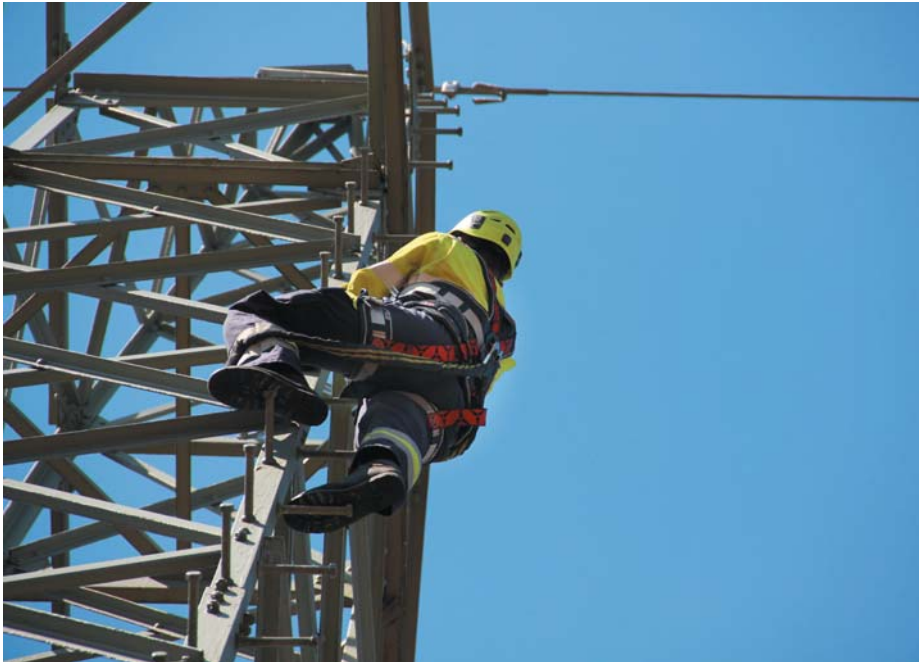
Mastkontrolle bei Syna
